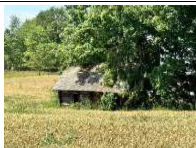
VZD neregistrētā pirts sliktā tehniskā stāvoklī
